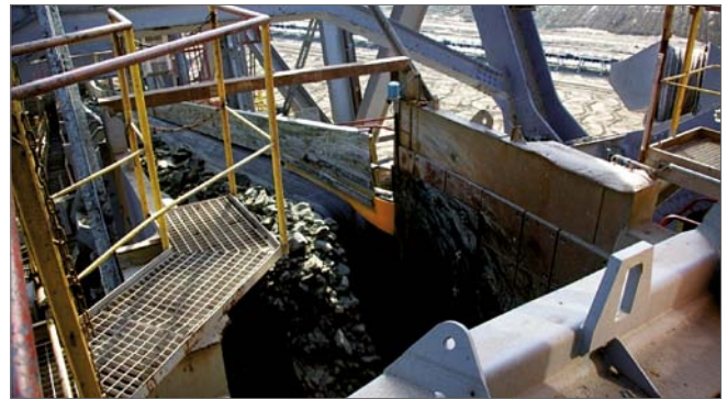
Fot. 1. Widoki stref zagrożenia związanych z przenośnikami taśmowymi drogi transportu typowej dla maszyn podstawowych
