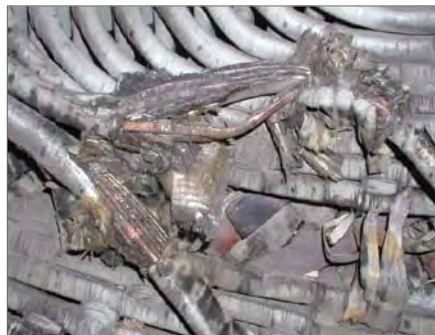
Rys. 15. Deformacja czoł po długotrwałym zwarceniu
