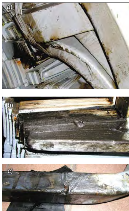
Rys. 20. Zwarcie łukowe pręta z rdzeniem stojana: a) lokalizacja zwarcia, b) wytopienie blach rdzenia stojana, c) uszkodzenia izolacji pręta
