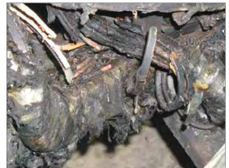
Rys. 17. Zniszczenia cewek w strefie ich główek
