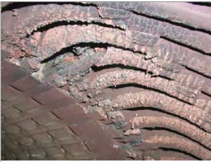
Rys. 12. Skutki zwarcia na wyjściu cewki ze żłobka rdzenia stojana
