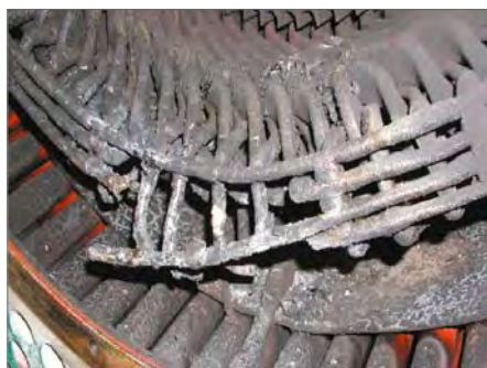
Rys. 18. Skutki zwarcia w strefie połączeń prądowych
