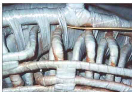
Rys. 19. Widok poluzowanych usztywnień czoł cewek do pierścienia usztywniającego
