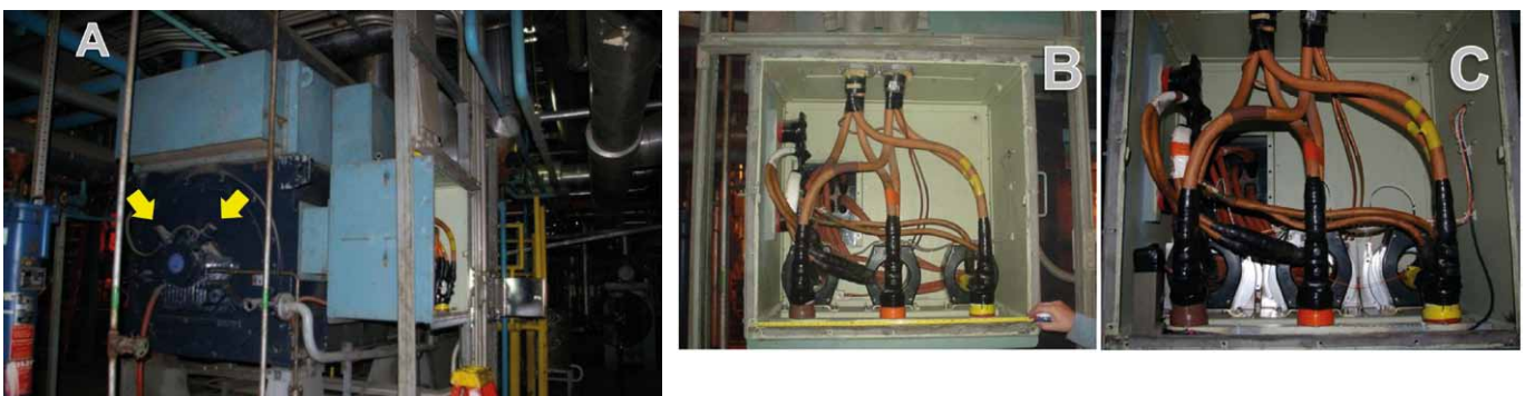
Rys. 15. Przykład instalacji HSCT dla silnika napędzającego pompę wody zasilającej (agregat łożyskowy ślizgowy): (A) widok silnika wraz ze skrzynką przyłączeniową kabli zasilających (B) przed instalacją czujników HSCT (C) po przeprowadzeniu ich instalacji
