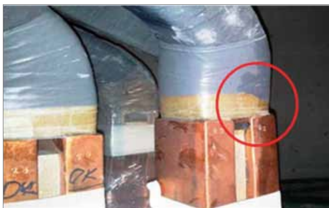
Rys. 7. Pręt stojana generatora z zanieczyszczeniem powierzchniowym izolacji
