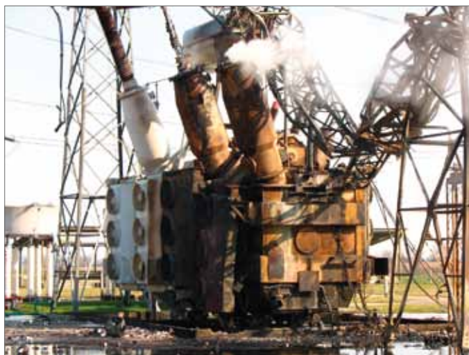
Fot. 3. Uszkodzone w wyniku eksplozji i pożaru przepusty izolatorowe strony 400 kV transformatora 250 MVA
