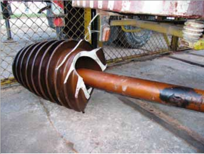
Fot. 1. Uszkodzony przepust izolatorowy 110 kV transformatora 70 MVA
