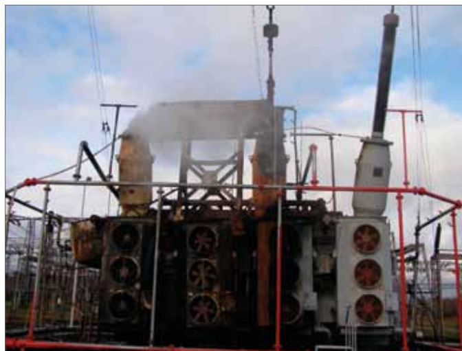
Fot. 4. Uszkodzony w wyniku eksplozji przepust izolatorowy fazy L1 strony 400 kV i pożaru bliźniaczy transformator 250 MVA
