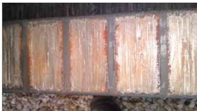
Rys. 11. Uszkodzona warstwa półprzewodząca pręta turbogeneratora 150 MW
