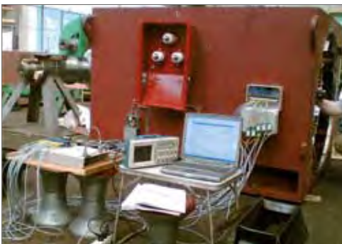
Rys. 8. Widok badanego stojana silnika oraz stanowisko pomiarowe w czasie kalibracji torów pomiarowych
