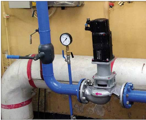
Rys. 9. Widok urządzenia modelowego po zamontowaniu w przewód sieciowy
