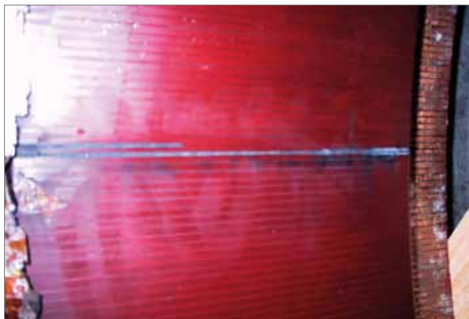
Rys. 5. Widok komutatora po demontażu. Widoczne wyraźne miejsce zwarcia
