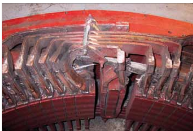
Rys. 3. Uszkodzenie prętów i połączeń uzwojenia kompensacyjnego
