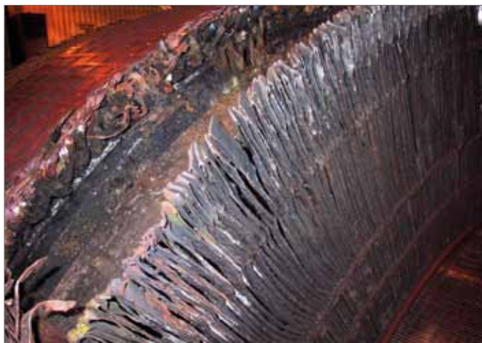
Rys. 2. Uszkodzenie uzwojenia wirnika i chorągiewek komutatora
