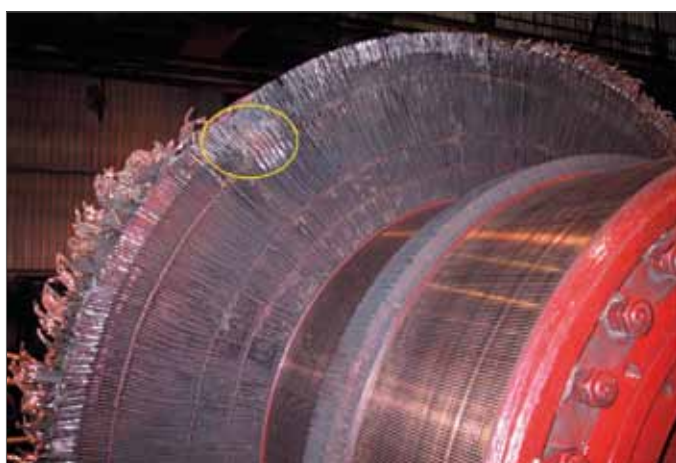
Rys. 4. Widok komutatora. Zaznaczono miejsce zainicjowania zwarcia
