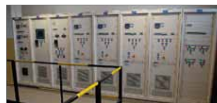
Rys. 4. Widok rozdzielni zasilająco-sterowniczej SNC Przepompowni „Telefoniczna”
