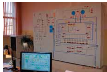
Rys. 5. Widok tablicy synoptycznej i stanowiska wizualizacji komputerowej Przepompowni „Telefoniczna”
