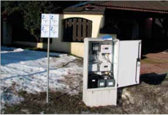
Rys. 2. Szafka telemetryczna dla OOS-u
