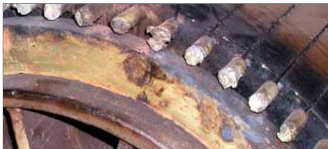
Rys. 3. Widok prętów klatki rozruchowej upalonych łukiem elektrycznym
