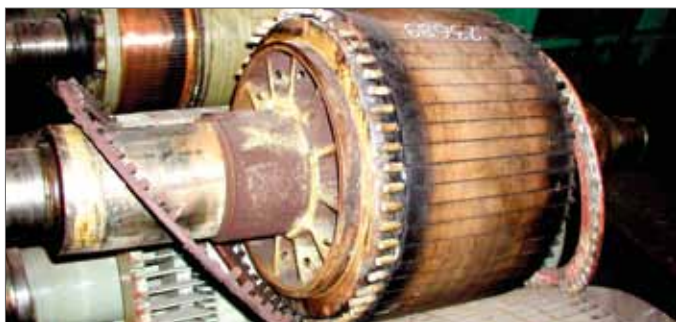
Rys. 2. Zniszczone uzwojenie klatki rozruchowej wirnika silnika napędu potrzeb własnych elektrociepłowni
