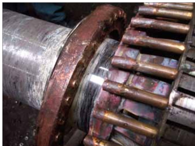
Rys. 6. Widok zerwanych wszystkich prętów klatki rozruchowej po stronie przeciwnapędowej
