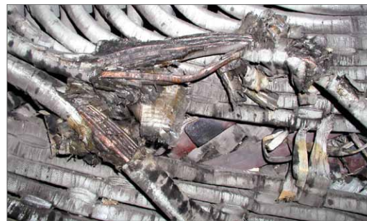
Rys. 14. Strefowe zniszczenie czoł cewek
