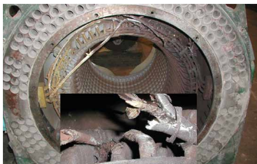
Rys. 17. Skutki zwarcia między połączeniami zasilającymi uzwojenie stojana
