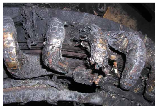
Rys. 16. Zniszczenia główek cewek
