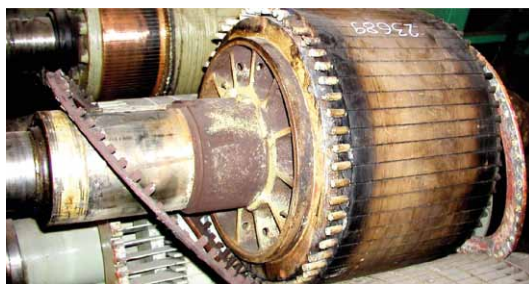
Rys. 18. Zniszczona klatka rozruchowa silnika dwuklatkowego
