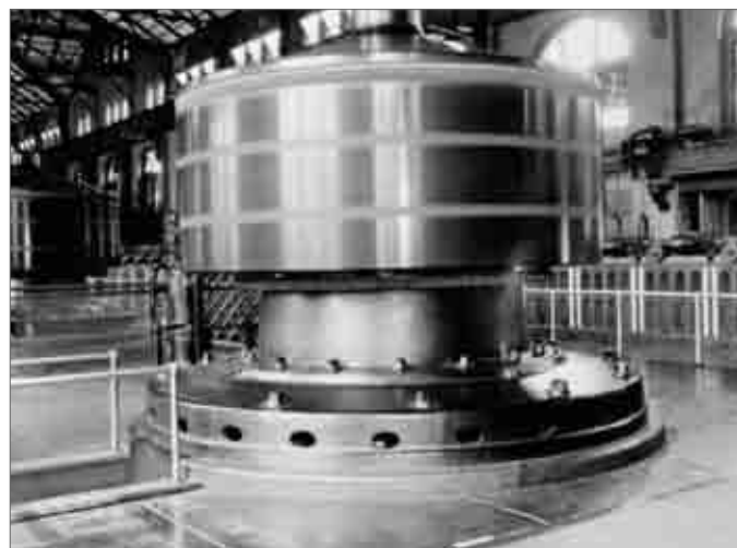
Fot. 5. Generator elektrowni na wodospadzie Niagara o mocy 5000 KM wg [8]
