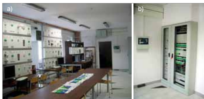
Rys. 2. Politechnika Poznańska: a) laboratorium KNX; b) rozdzielnica elektryczna budynku
