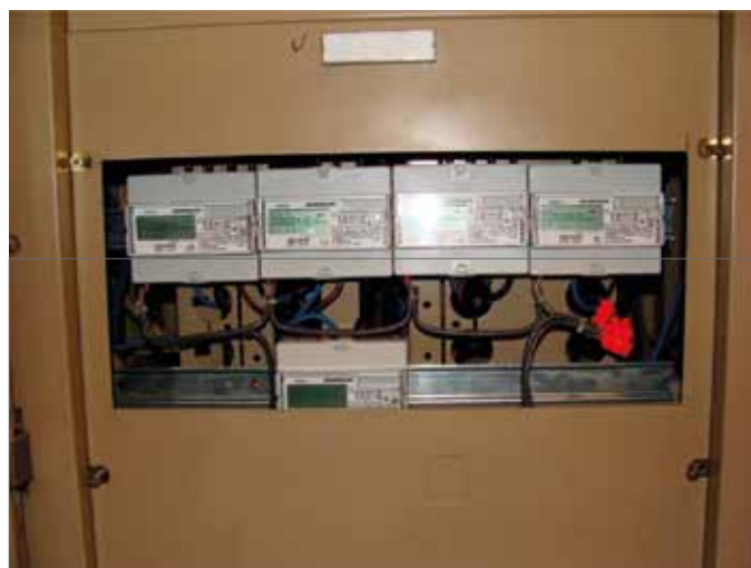
Rys. 6. Liczniki zainstalowane w budynku B-1 AGH – sekcja 1
