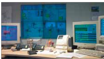
Fot. 1. Fragment systemu dyspozytorskiego SD 2000
