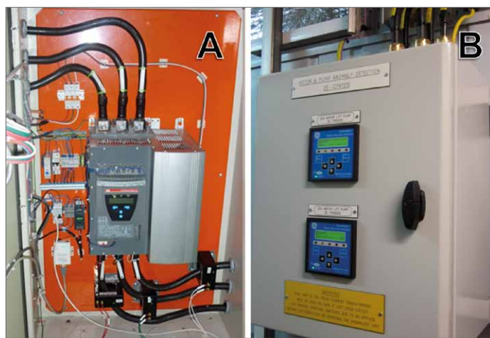
Rys. 14. Przekładniki prądowe zainstalowane na kablach zasilających silnika (A) oraz dwa monitory AnomAlert zainstalowane w drzwiach szafki wiszącej (B) sterowania niskonapięciowych silników pomp
