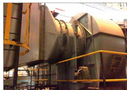
Rys. 9. Wentylator instalacji wymiany powietrza w hali
