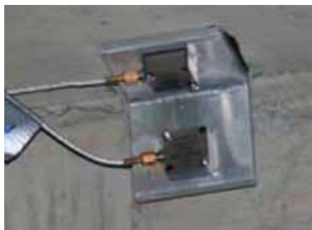
Rys. 5. Akcelerometr do pomiarów drgań na konstrukcji mostu [3]
